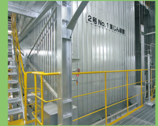
●集じん装置(バグフィルター) 排ガス中のばいじんをフィルターによって除去し、ダイオキシン類、重金属類も除去します。
