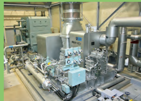
●蒸気タービン発電機 ボイラで発生した蒸気によって駆動され、発電しています。この電力は所内電気をまかない、余剰電力は売電しています。
