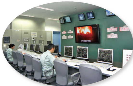
●中央制御室 施設内の機器監視・操作はここでっており、本施設の頭脳と言えるところです。
