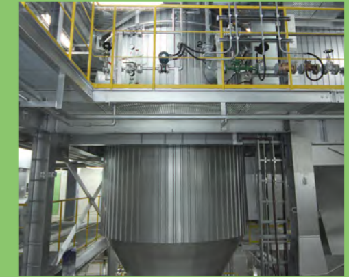
●減温塔 排ガスに水を噴射し、温度を下げ、集じん装置が能力を十分発揮できる温度にしています。
