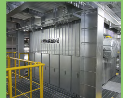
●触媒反応塔 排ガス中にアンモニアガスを吹き込み、触媒を介して窒素酸化物を還元分解除去しています。
